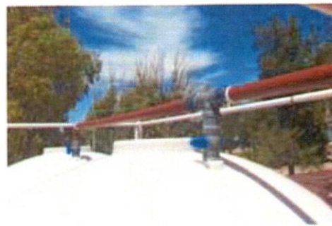
Sistema de llenado de tanques
