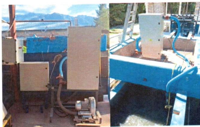
Equipo de ozono para oxidación de metales.
