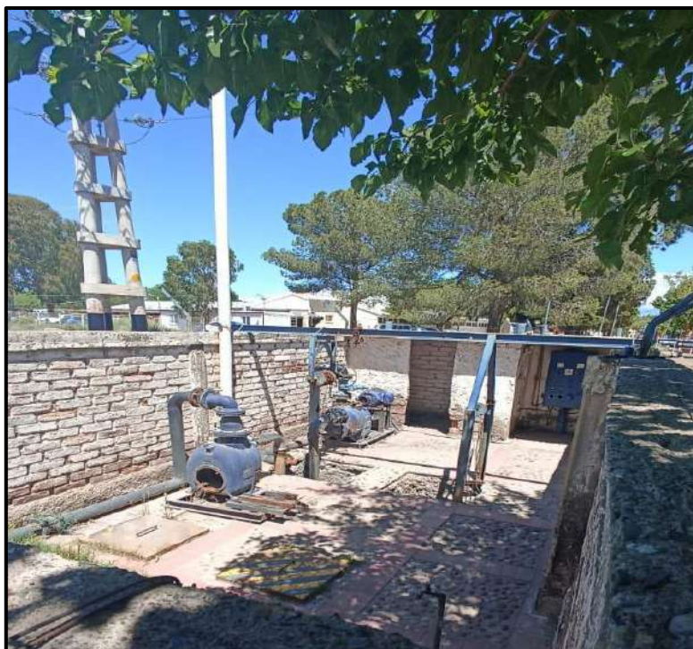
Ilustración 4: Equipamiento de la estación elevadora existente
