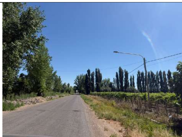
FOTO 16- Vista tramo calle Milagro y estado del asfalto
