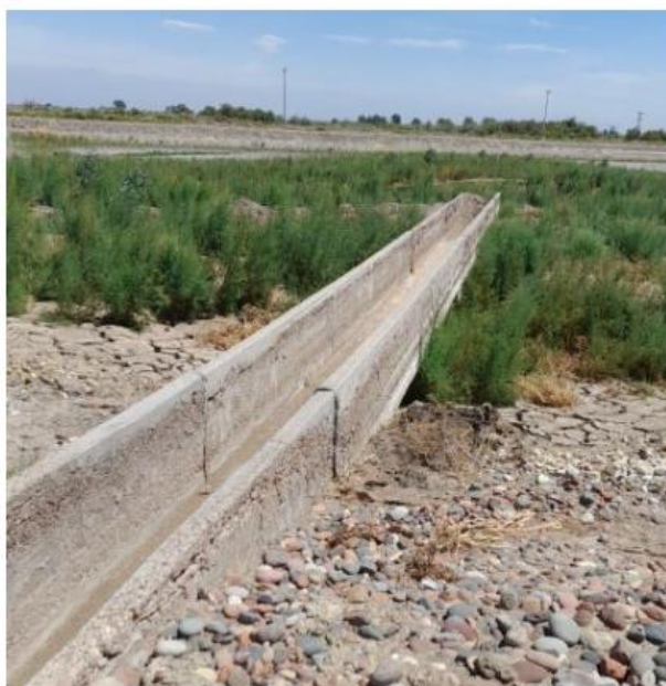
Figura 17: Estado del canal de ingreso
